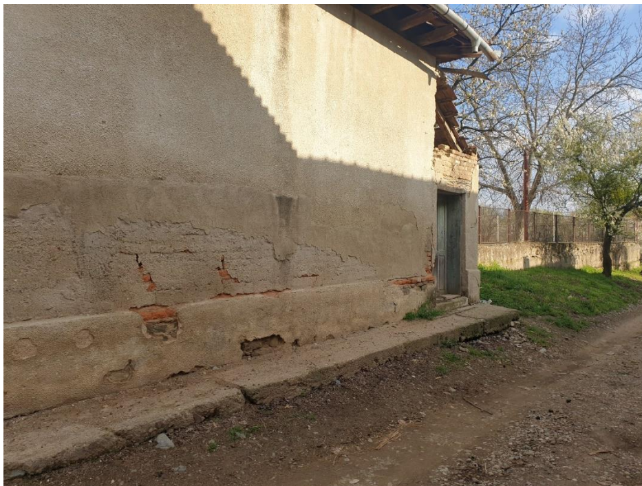
FOTO 17 –Fațada laterală dreapta. Tencuieli desprinse local
