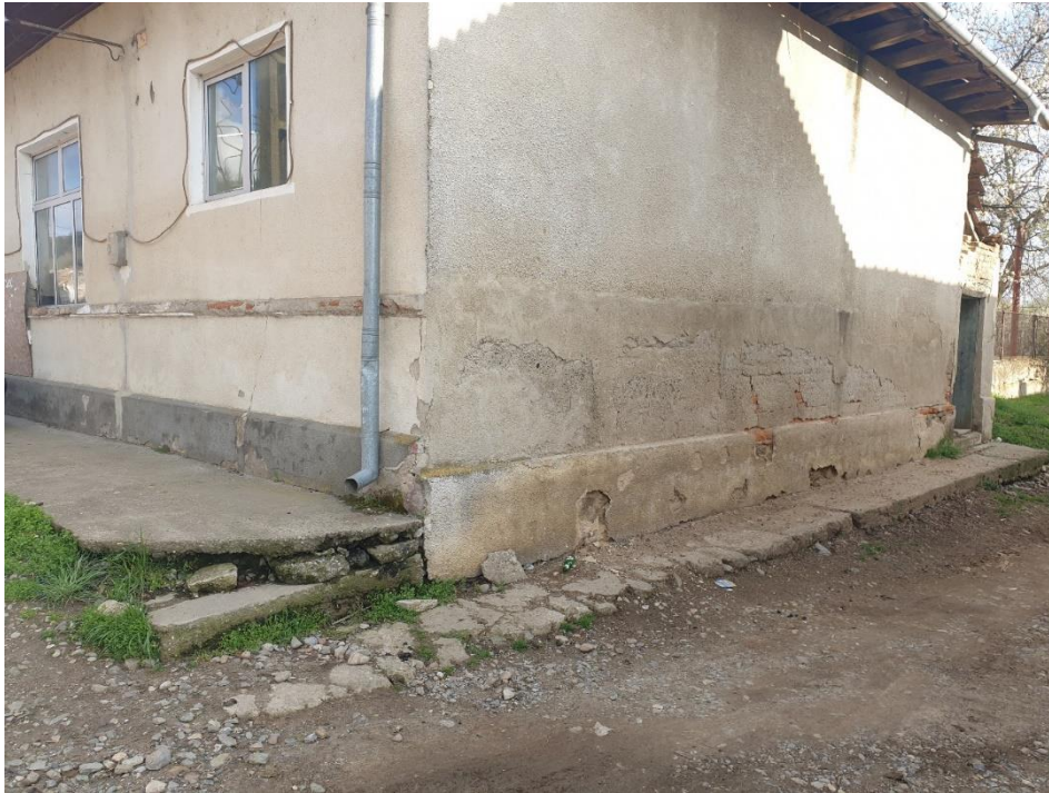
FOTO 16 –Fațada principală și laterală dreapta. Tencuieli desprinse local. Apa pluvială captată de pe acoperiș este deversată prin burlanul de la colț în imediata vecinătate a peretelui exterior, neexistând o rigolă care să o preia și să o îndepărteze de construcție
