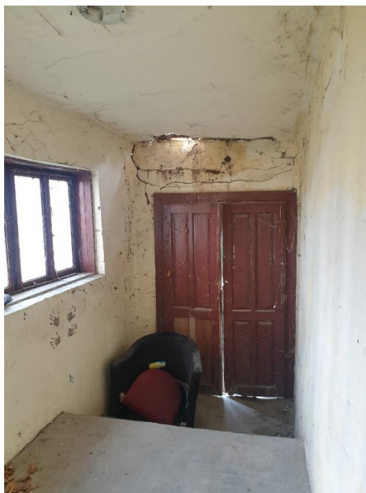
FOTO 47 –Imagini din interiorul corpului lateral. Zugrăveli vechi, degradate, scurgeri de apă la tavan și pe pereți
