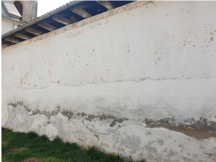
FOTO 10 –Fațada laterală stânga. Tencuiala căzută la pereți pe alocuri. Peretele exterior prezintă umiditate marcată la bază. Se poate observa centura de la partea superioară a zidurilor
