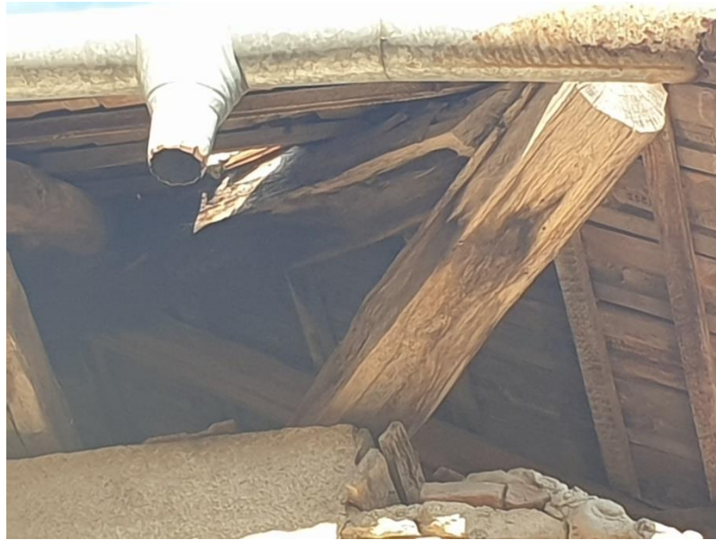
FOTO 18 –Fațada laterală dreapta. Lipsește complet burlanul de la jonțiunea dintre corpul principal și corpul mic, amplasat în lateral incomplet la colț, astfel că apa pluvială captată de pe acoperiș se scurge din jgheaburi direct pe peretele exterior. La corpul mic lipsește sistemul de jgheaburi și burlane. Din cauza apei care s-a scurs direct pe pereți, s-au produs degradări ale zidăriei la corpul lateral
