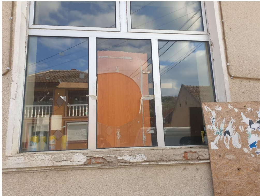
FOTO 6 –Fațadă principală. Tencuieli desprinse local, geamuri sparte
