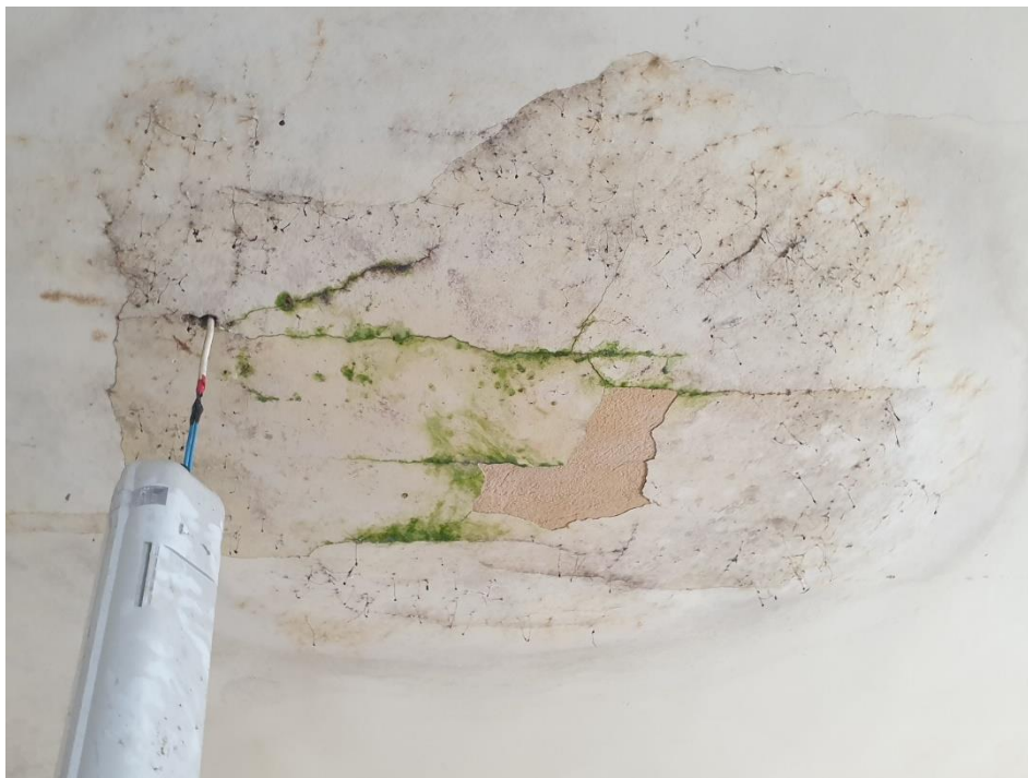
FOTO 37 –Imagine din interior. Scurgeri de apă din pod la tavan, în zona instalației electrice pentru iluminat interior
