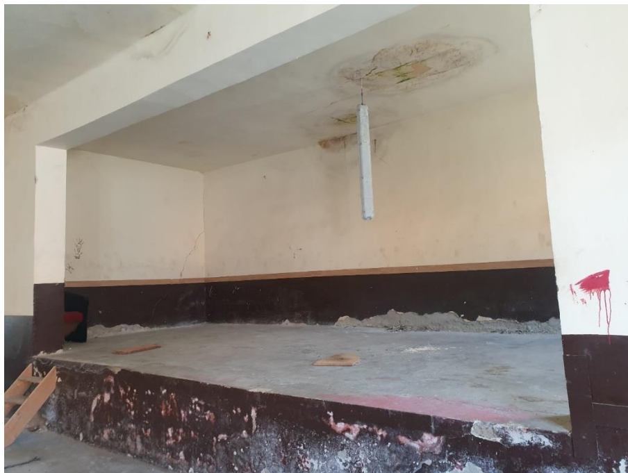
FOTO 33 –Scena – pardoseală din ciment sclivisit. Scurgeri de apă din pod la nivelul tavanului și pe peretele exterior. Zugrăveli și vopsitorii învechite, exfoliate
