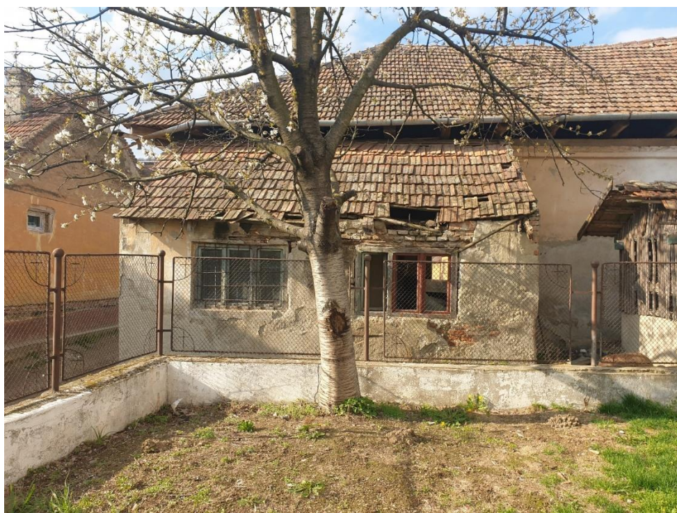
FOTO 15 –Fațada posterioară. Corpul lateral care adăpostește accesul secundar prezintă deformații și degradări mari la nivelul acoperișului și la partea superioară a pereților și este propus spre demolare
