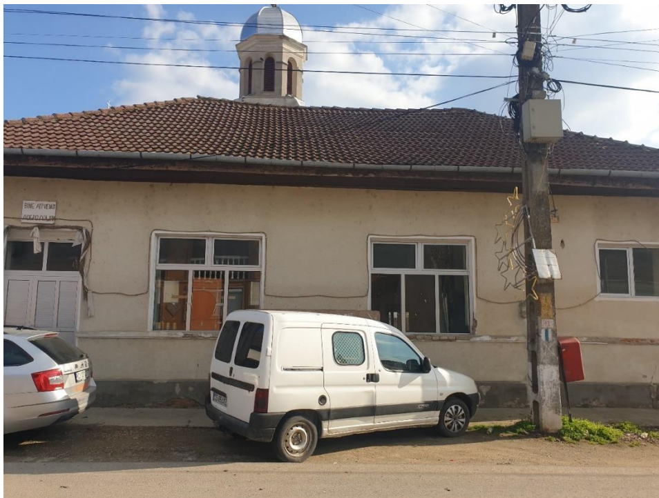
FOTO 3 – Vedere din exterior – fațadă principală. Acoperiș cu deformație în formă de șa specifică acoperișurilor vechi, cu elemente ale șarpantei deformată și degradate
