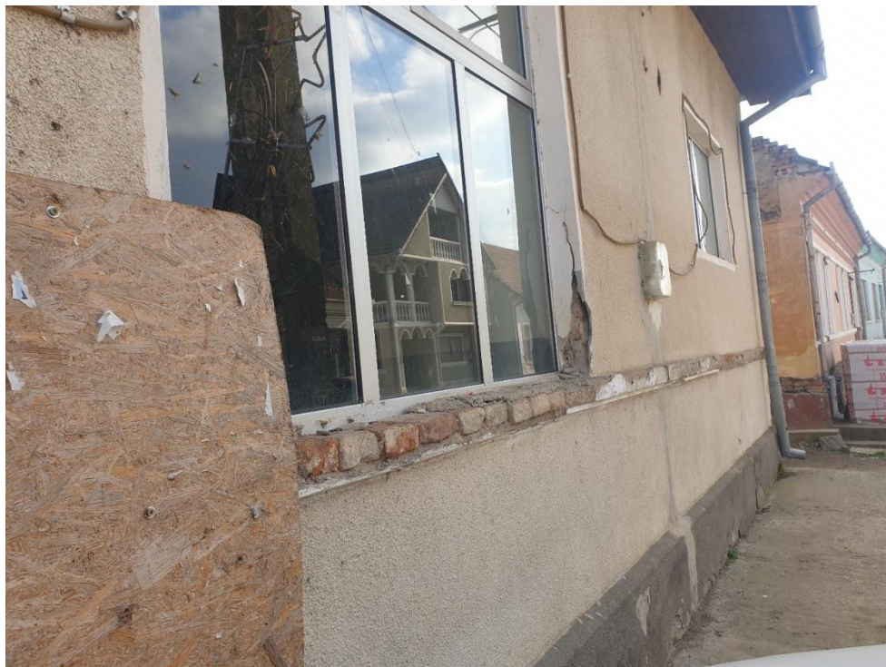
FOTO 5 –Fațadă principală. Tencuieli desprinse local
