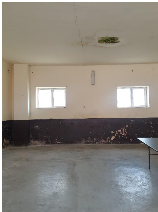
FOTO 28 – Vedere din interior. Pardoseală ciment sclivisit. Zugrăveli și vopsitorii învechite, exfoliate. Apă scursă din pod în centrul tavanului sălii
