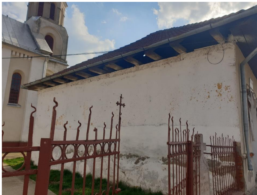
FOTO 7 – Vedere din exterior – fațada laterală stânga. Tencuiala căzută la pereți pe alocuri, burlan incomplet la colț, prin care nu se mai asigură îndepărtarea apelor pluviale de la construcție, acestea scurgându-se chiar în dreptul fundației. Peretele exterior al fațadei laterale prezintă umiditate marcată la bază. Jgheburile existente sunt vechi și deformat. Se poate observa centura de la partea superioară a zidurilor
