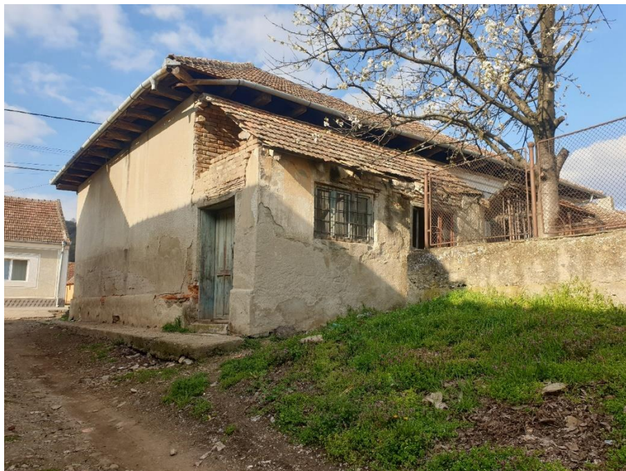
FOTO 21 —Fațada laterală dreapta și posterioară. Lipsește complet burlanul de la jonțiunea dintre corpul principal și corpul mic, amplasat în lateral, astfel că apa pluvială captată de pe acoperiș se scurge din jgheaburi direct pe peretele exterior. La corpul mic lipsește sistemul de jgheaburi și burlane și lipsesc și țigle, cornișa este ruptă și căzută parțial, apa s-a scurs și în interior. Din cauza apei care s-a scurs direct pe pereți, s-au produs degradări ale zidăriei la corpul lateral
