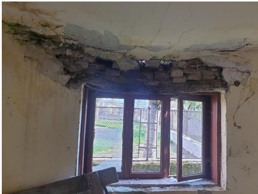
FOTO 45 –Imagini din interiorul corpului lateral. Buiandrug din lemn putrezit, aflat în pragul colapsului, zidăria de deasupra buiandrugului complet degradată
