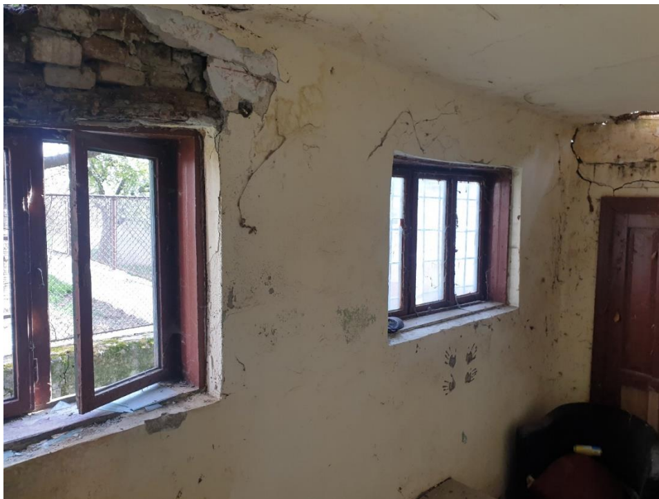
FOTO 46 –Imagini din interiorul corpului lateral. Buiandrug din lemn putrezit, aflat în pragul colapsului, zidăria de deasupra buiandrugului complet degradată, zugrăveli vechi, degradate
