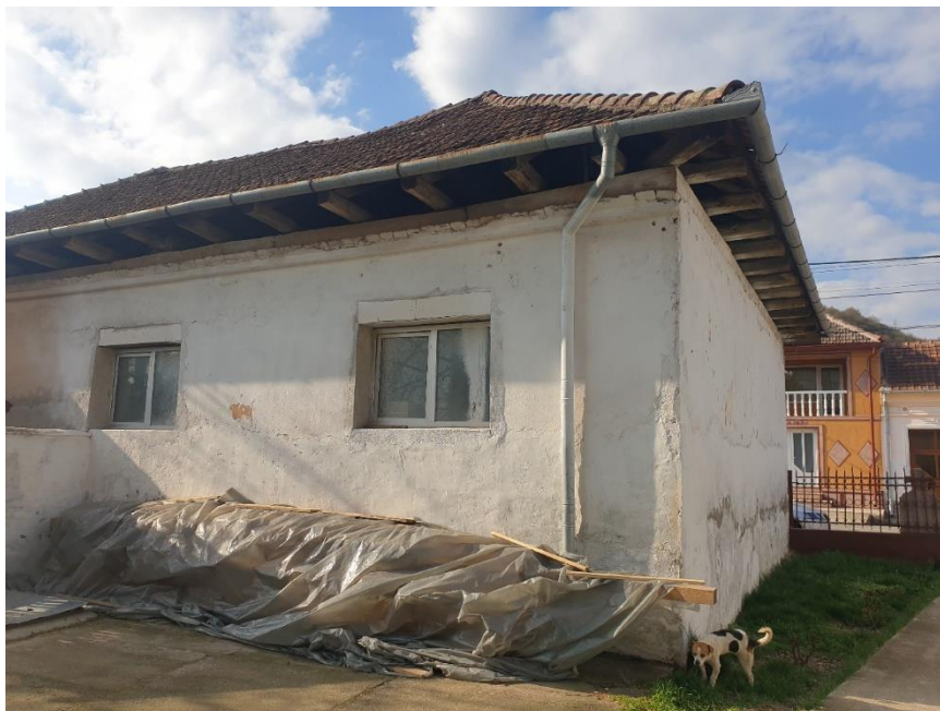
FOTO 12 –Fațada posterioară. Centură de beton la partea superioară a zidului exterior. Acoperiș deformat în formă de șa. Burlan incomplet la colț, prin care nu se mai asigură îndepărtarea apelor pluviale de langa construcție, acestea scurgându-se chiar în dreptul fundației. Peretele exterior al fațadei laterale stânga prezintă umiditate marcată la bază. Jgheburile existente sunt vechi și deformat.
