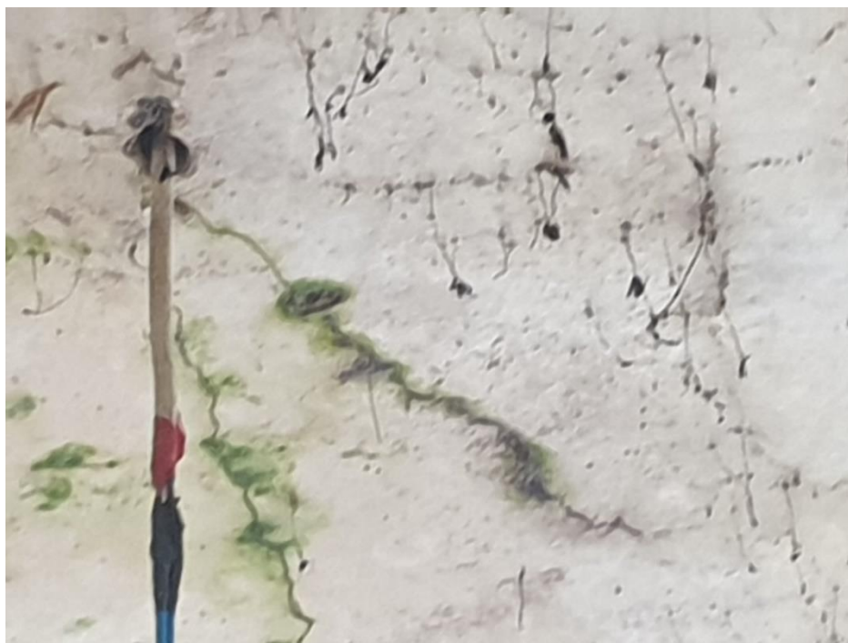
FOTO 38 –Imagine din interior. Scurgeri de apă din pod la tavan, în zona instalației electrice pentru iluminat interior
