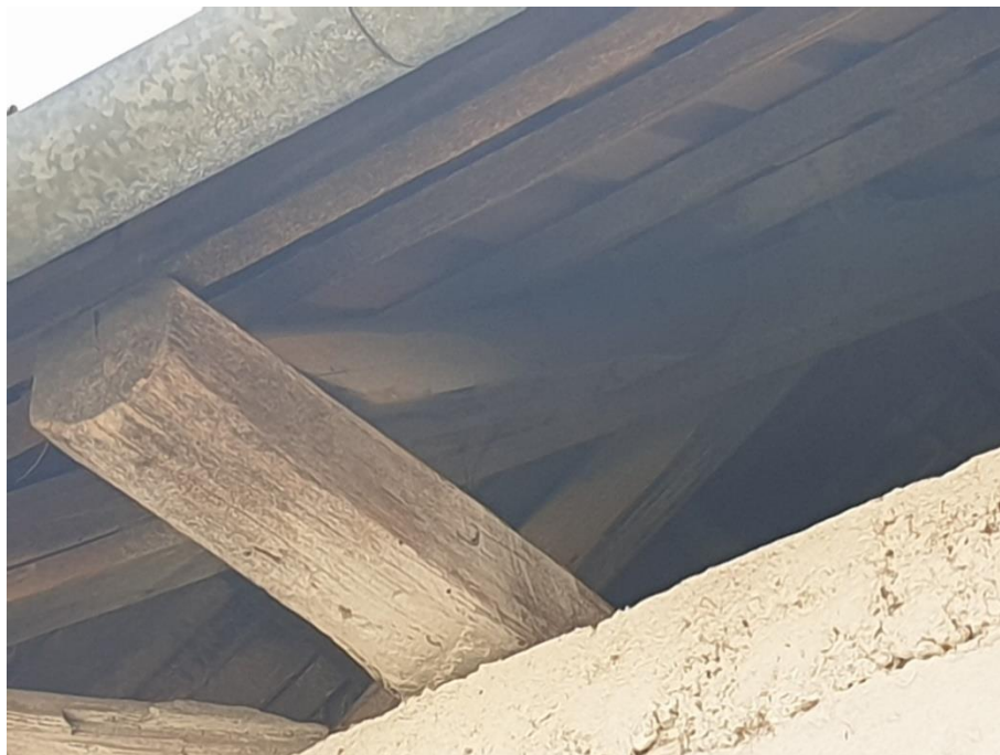
FOTO 11 –Fațada laterală stânga. Centură de beton la partea superioară a zidului exterior. Elemente șarpantă din lemn ecarisat vizibile – coardă, căpriori
