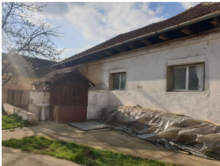
FOTO 13 –Fațada posterioară. Centură de beton la partea superioară a zidului exterior. Acoperiș deformat în formă de șa
