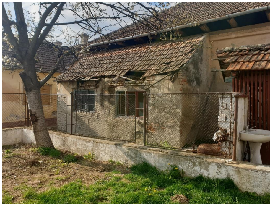
FOTO 14 –Fațada posterioară. Corpul lateral care adăpostește accesul secundar prezintă deformații și degradări mari la nivelul acoperișului și la partea superioară a pereților și este propus spre demolare
