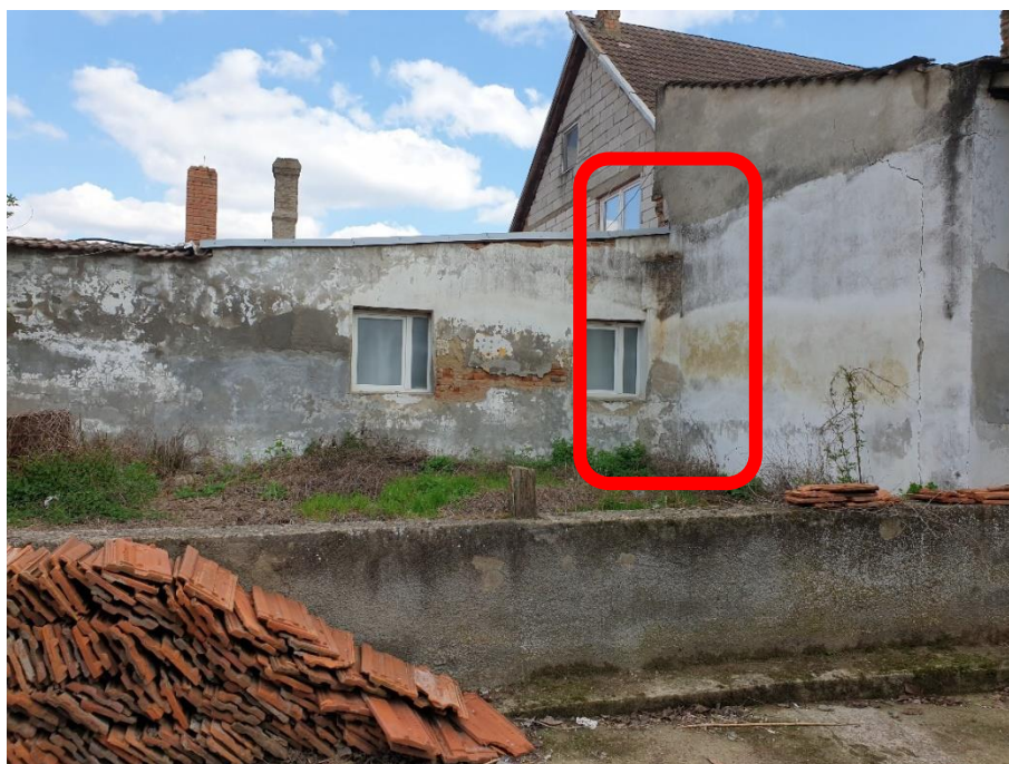
FOTO 22 —Perete transversal șir 5, între D și F. Fisuri prezente la perete portant. Zugrăveli învechite și exfoliate. Calcan existent spre curte. Alipire la construcția de pe parcela învecinată din partea dreaptă
