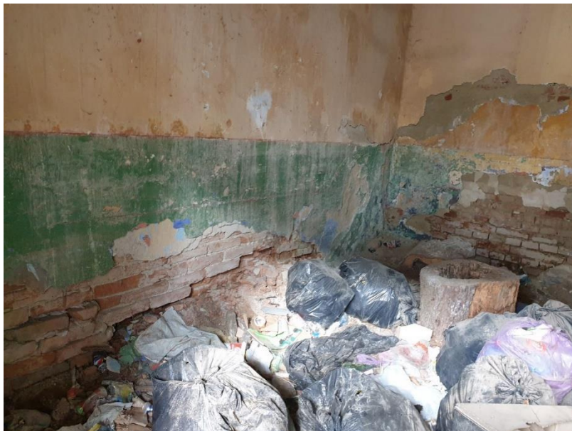
FOTO 31 – Imagine din interiorul camerei 4 (cuprinsă între D, F, 3, 5). Stare avansată de degradare la baza pereților. Moloz și diverse materiale depozitate pe pardoseală, fiind insalubră
