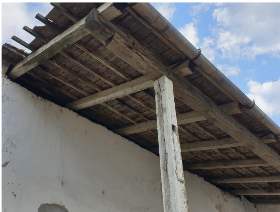
FOTO 26 – Pridvor cu stâlpii deformați, elementele din lemn ale acoperișului afectate de umiditate și deformate, țigle căzute la marginea acoperișului, jgheaburi vechi și deformate
