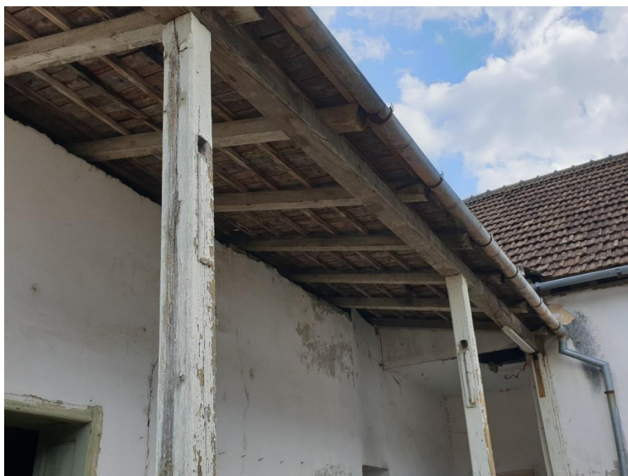
FOTO 27 – Pridvor cu stâlpii deformați, elementele din lemn ale acoperișului afectate de umiditate și deformat, țigle căzute la marginea acoperișului, jgheaburi vechi și deformat
