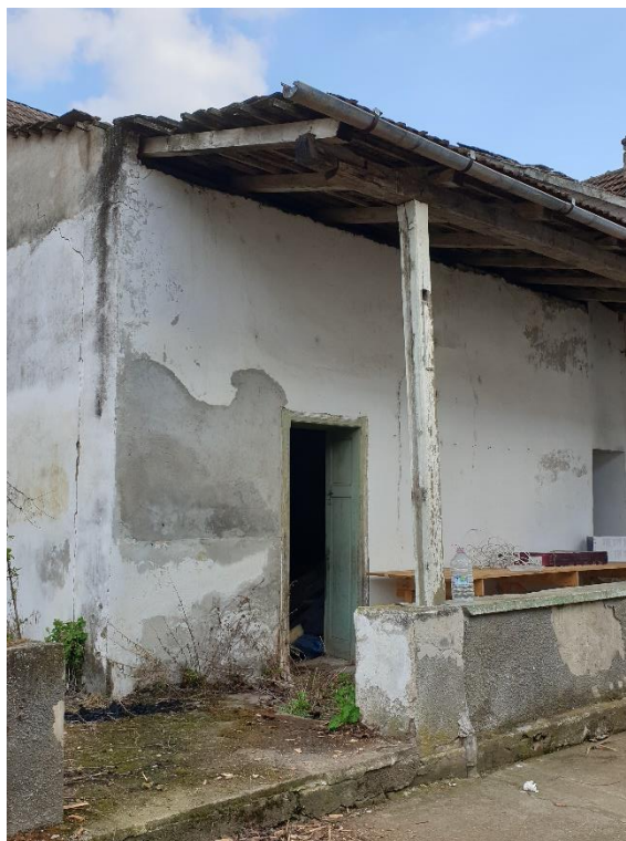
FOTO 25 – Pridvor cu stâlpii din lemn deformați, parapet afectat de umiditate, cu tencuiala desprinsă. Pardoseala pridvorului foarte umedă
