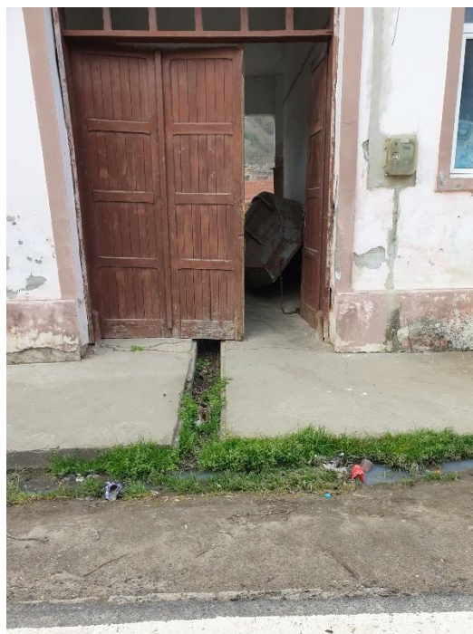
FOTO 7 –Fațada principală. Accesul principal. Poartă veche, deformată, zugrăveli și tencuieli vechi, exfoliate, cu desprinderi locale
