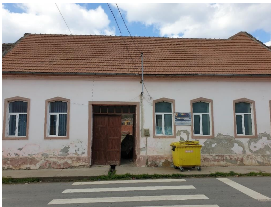
FOTO 2 – Fațadă principală. Zugrăveli și tencuieli exfoliate, desprinse parțial, umiditate la baza pereților. Țigla a fost înlocuită relativ recent pe apa dinspre stradă a acoperișului
