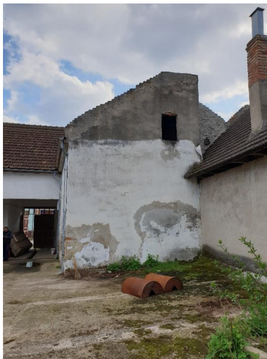
FOTO 20 - Perete transversal șir 4, între A și B. Tencuiala parțial desprinsă la partea inferioară a peretelui, umiditate prezentă la partea inferioară. Calcan existent spre curte. Alipire la construcția de pe parcela învecinată din partea stângă
