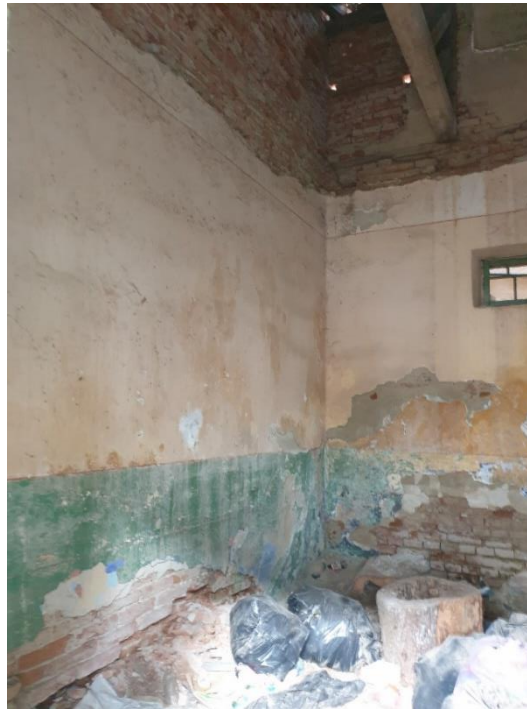
FOTO 30 – Imagine din interiorul camerei 4 (cuprinsă între D, F, 3, 5). Stare avansată de degradare ca urmare a faptului că nu s-au mai realizat lucrări de reparații și întreținere curentă. Încăperea este neutilizată momentan, cu moloz și diverse materiale depozitate pe pardoseală, fiind insalubră. La baza pereților a căzut tencuiala și este prezentă umezeala, mortarul din rosturi e afectat, zugrăvelile sunt vechi și exfoliate. Calcanele existente sunt netencuite, în unele locuri prezintă găuri și se află într-un echilibru precar
